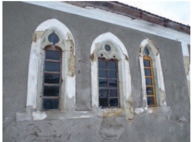
Gótikus ablakkeretek málló vakolattal
